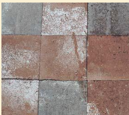
Dlažba s vápennými výkvěty před očištěním
