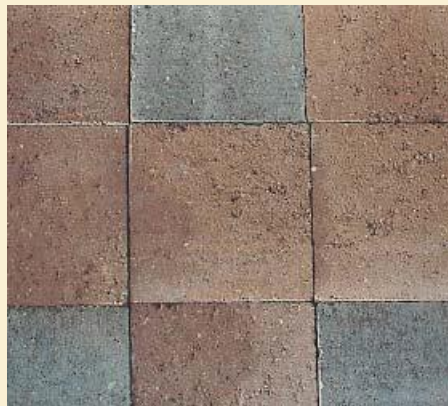
Dlažba s vápennými výkvěty po očištění
